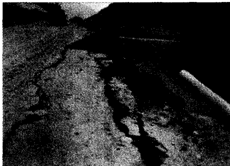
图8 路基边坡开裂
