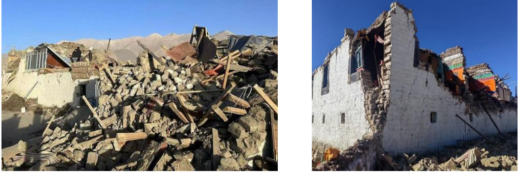
图8 土木和砖木结构破坏情况
