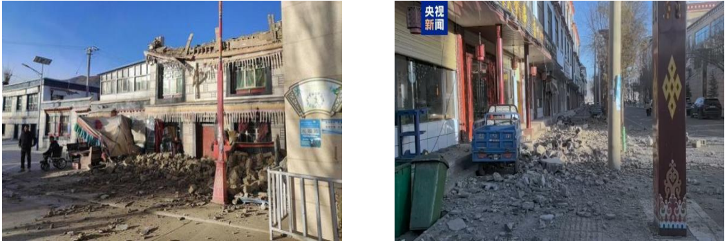
图9 砖混结构破坏情况
